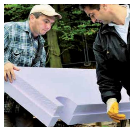
Aussparungen in der Wärmedämmschicht, z.B. durch Entwässerungsleitungen, lassen sich mit einer Tiger- oder Motorsäge ausschneiden.
